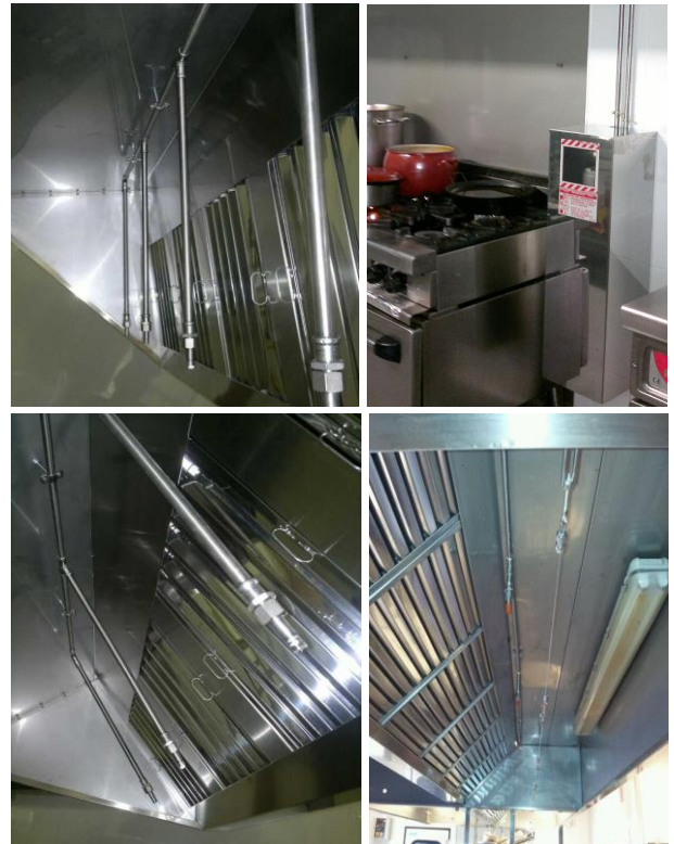
Photos : Armoire et lignes du système CROCADE
